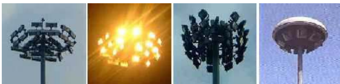
Fig.17 - Torri faro "palesemente" inquinanti. Nell'ultimo impianto a destra infatti, il cappello ha l'unico obiettivo di proteggere gli apparecchi d'illuminazione dalle intemperie. [Immagine fornita da CieloBuio]
