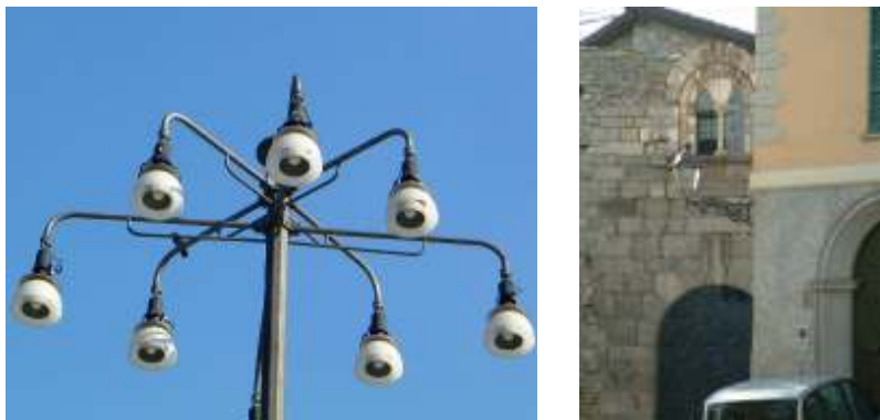
Fig.4 – Esempio di messa a norma di impianti d'illuminazione d'epoca: con semplici e poco costose schermature (foto di sinistra) oppure, nel caso della foto di destra, ricondizionando antiche lanterne e facendole rientrare nella deroga dei 15 cd/klm a 90^\circ ed oltre . [Immagine fornita da CieloBuio]
